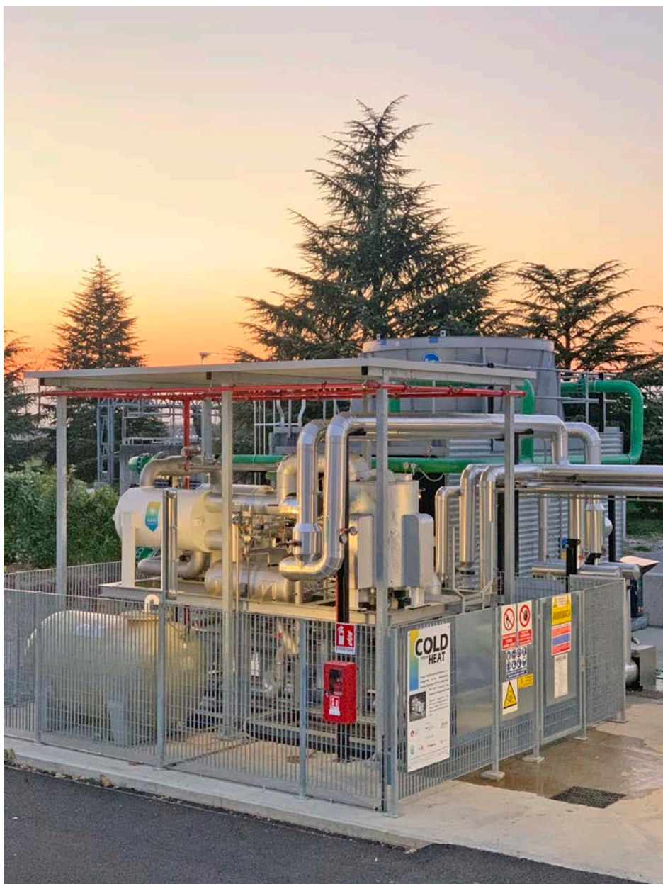
Abbildung 1: „Cold from Heat“ – Außenansicht einer Ammoniak-Wasser-Absorptionskältemaschine in einem Pharmaunternehmen (Italien), Kälteleistung 450 kW
